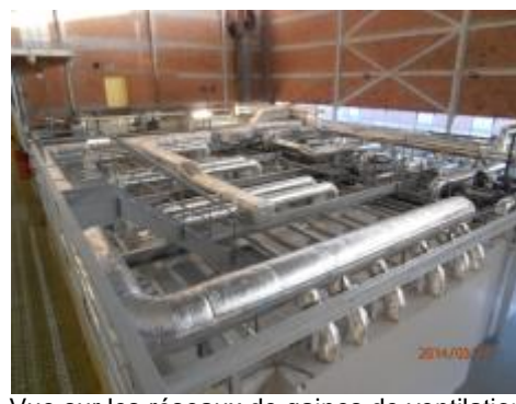
Vue sur les réseaux de gaines de ventilation alimentant les salles blanches depuis le plafond
